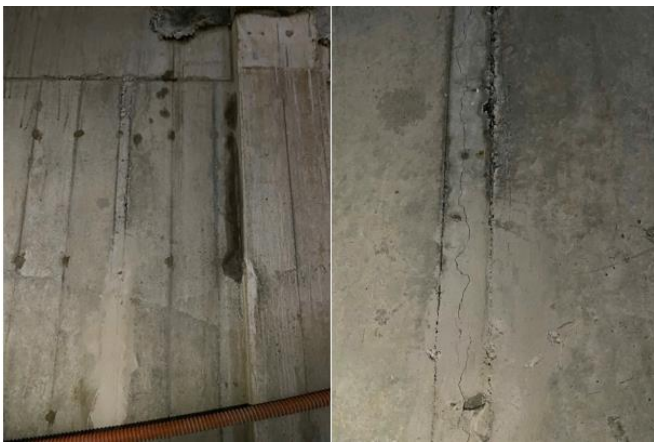
Hình 1: Các vết nứt trên vách tầng hầm tại khu vực Quận 1
