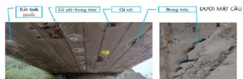
Hình 3. Hiện tượng bong tróc bê tông dưới mặt cầu
